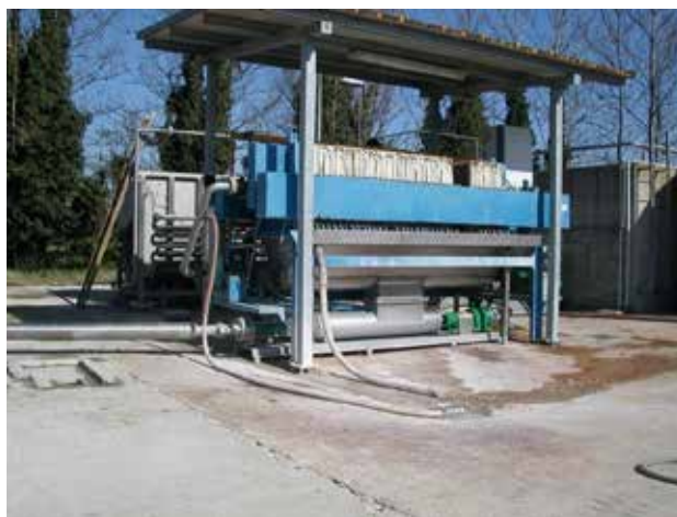
Čerpadlo DHS Používá se za kalolísem pro recyklaci sušeného kalu.
